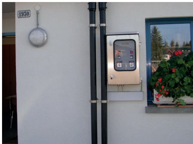
Impianto di depurazione acque
