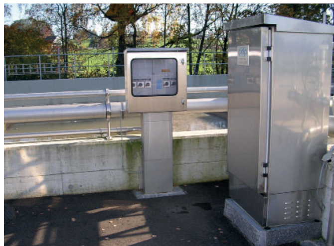
Impianto di depurazione acque
